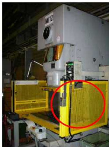
図 2-6 プレス側面の固定式ガード
