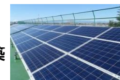
太陽光パネル
