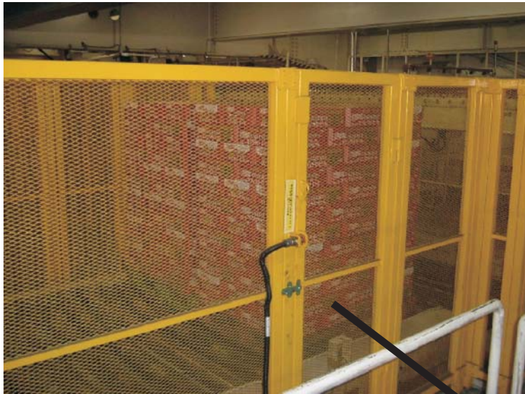
防護柵の扉部分 (金網付き、プラグスイッチ付き)
