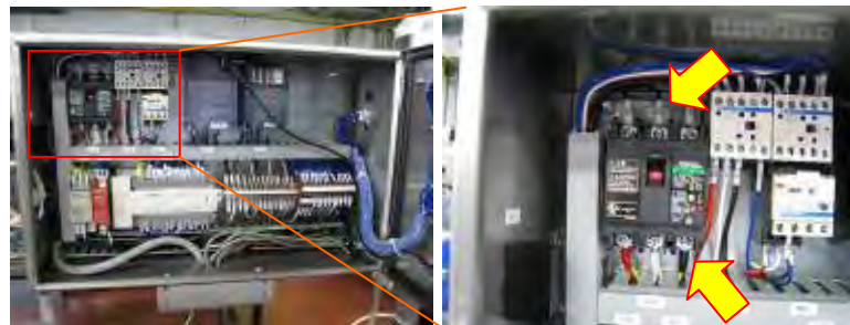
図 13. 操作盤内の電氣的危険源
