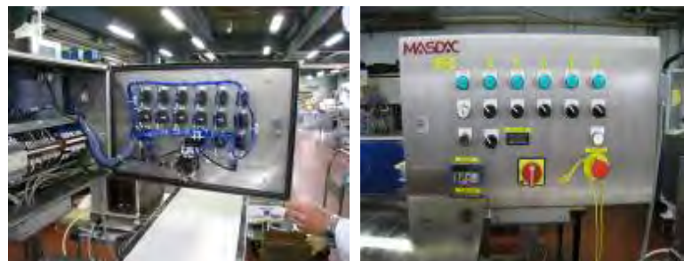
図 14. 操作盤扉の電氣的危険源
