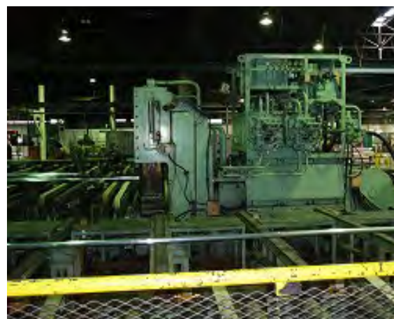
⑤後面設備（ストレッチャー－2）
